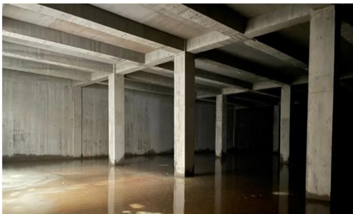
新北高中地下貯水槽
